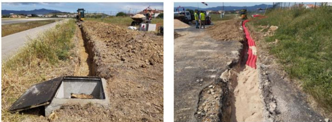
Figura 24 - Valas técnicas Aeroporto de Cascais
