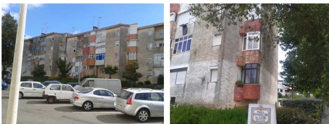
Figura 50. Estado de conservação das fachadas do Bairro da Madorna
