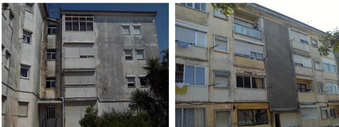
Figura 48. Estado de conservação das fachadas do Bairro da Torre
