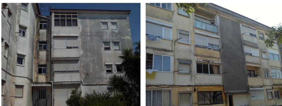
Figura 2. Estado de conservação das fachadas do Bairro da Torre
